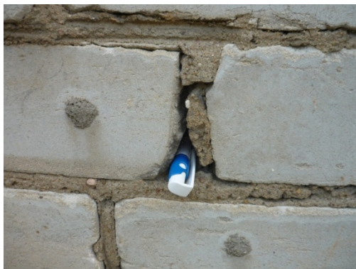
Рис. 3.7. Сквозные трещины по швам кирпичной кладки
