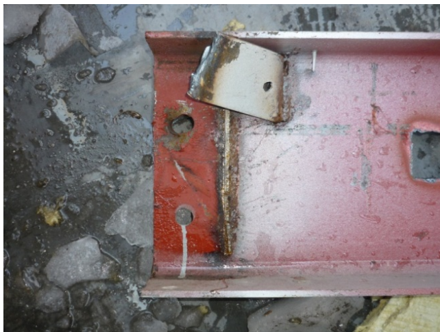
Рис. 3.11. Повреждения из-за некачественно выполненных сварных соединений
