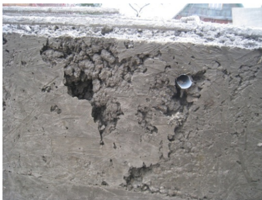
Рис. 2.13. Глубокие раковины в конструкции железобетонного монолитного ленточного фундамента
