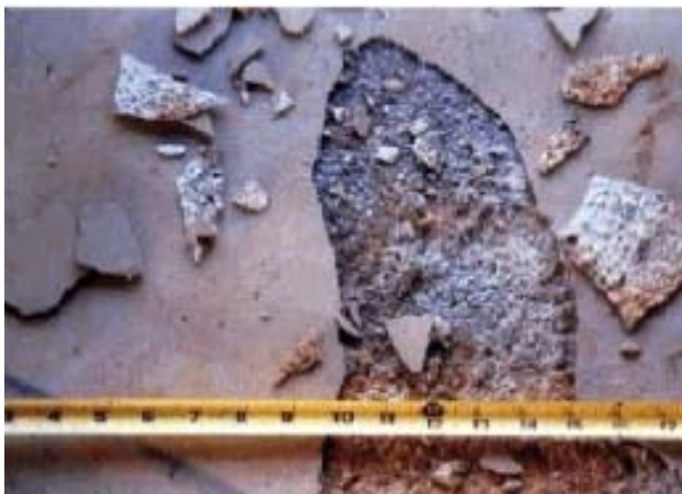
Рис. 2.2. Расслоение железобетонной конструкции
