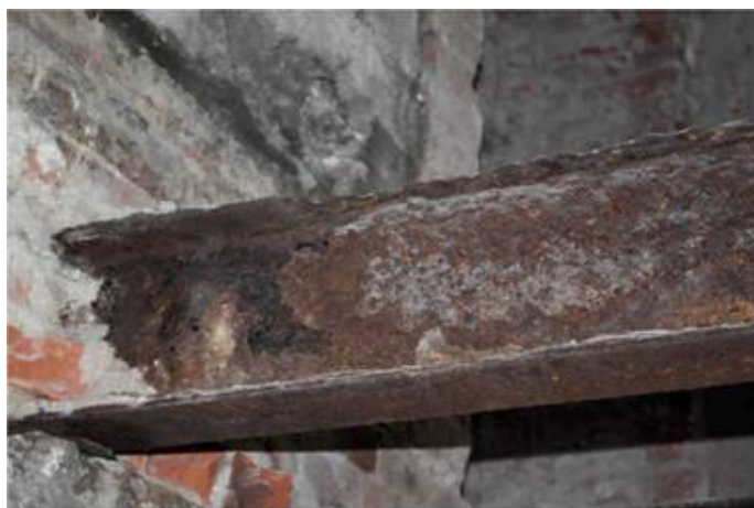
Рис. 3.12. Биоповреждение стальной балки
