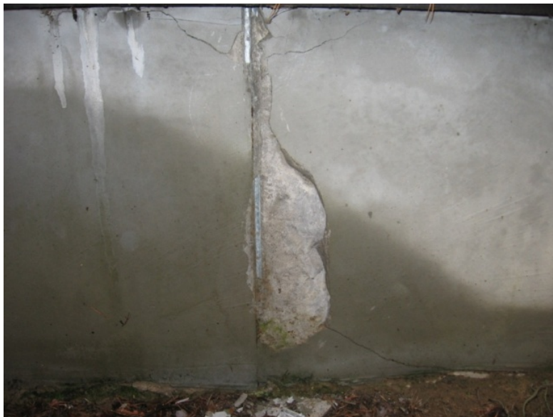
Рис. 2.9. Разрушение стен подвала вследствие систематических протечек
