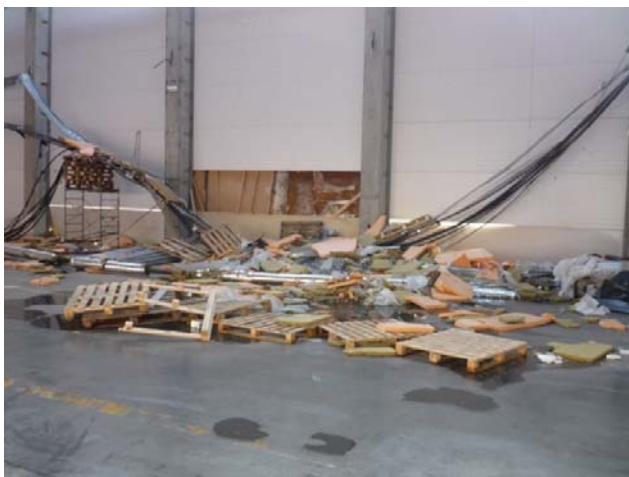
Рис. 3.10. Обрушение металлической конструкции кровли
