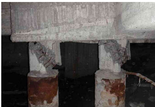
Рис. 2.5. Разрушение опорных частей столбчатого монолитного фундамента
