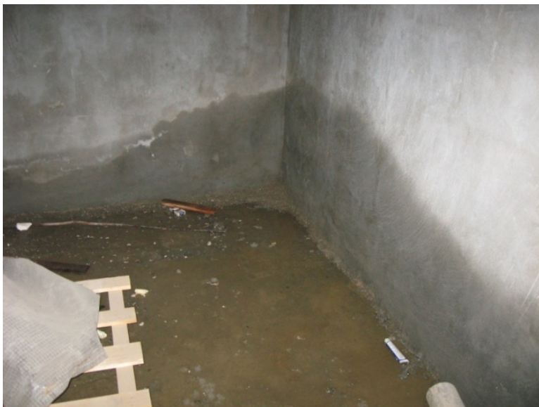
Рис. 2.11. Затопление подвала вследствие некачественно выполненной гидроизоляции
