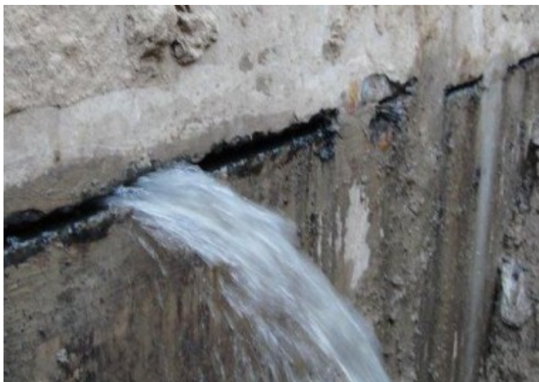
Рис. 2.10. Протечки грунтовых вод
