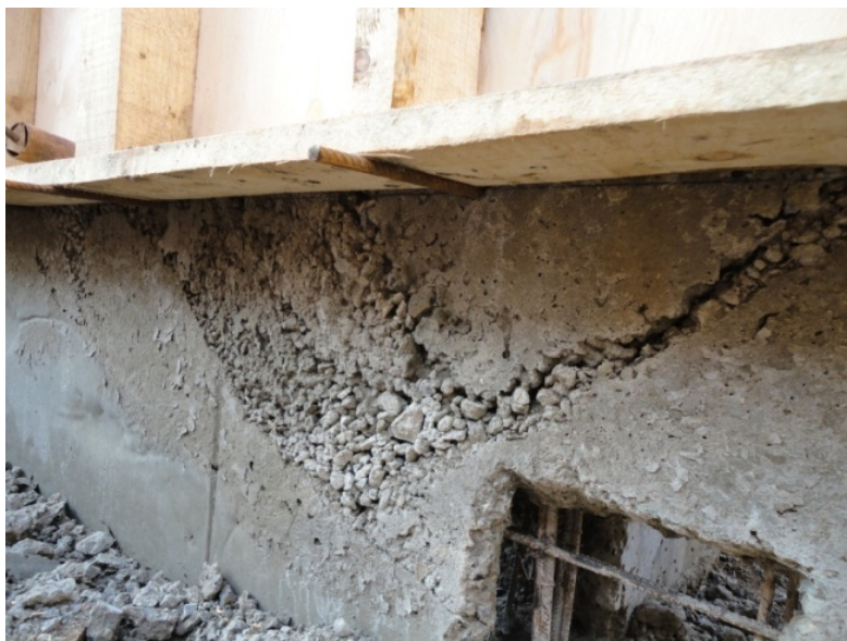
Рис. 2.1. Раковины в железобетонных монолитных фундаментных стенах
