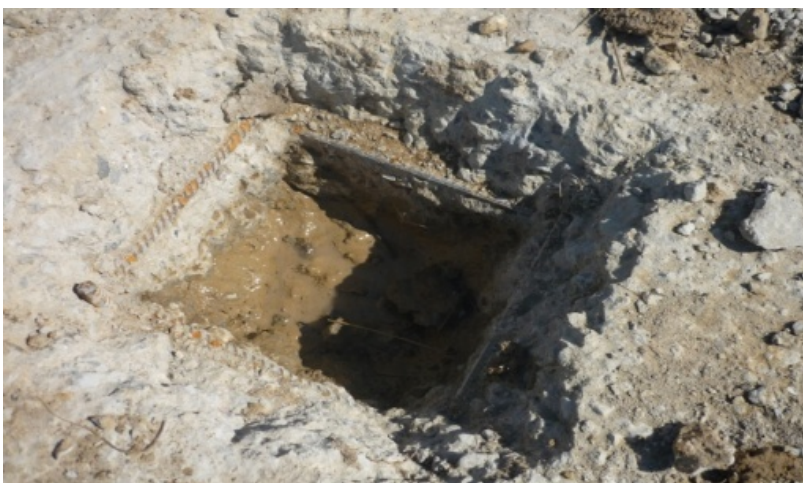
Рис. 2.15. Фундамент не имеет достаточной глубины заложения
