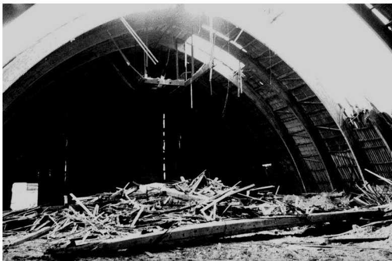
Рис. 3.14. Общий вид склада из клееных деревянных конструкций после аварии из-за сверхнормативной односторонней снеговой нагрузки
